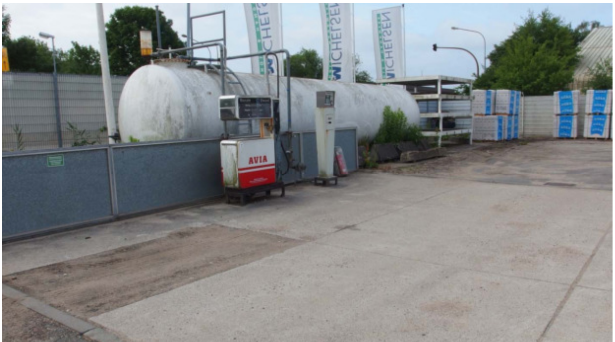
Abb. 12: Blick nach Südwesten auf die DK-Eigenverbrauchstankstelle im südwestlichen Grundstücksbereich. Im Vordergrund die flüssigkeitsdichte Fahrbahn mit der Zapfsäule. Dahinter der oberirdische 30 m 3 Dieseldieseltankstofftank (Nr. 9 Ergebnisplan). Die Tankstelle wurde 2018 außer Betrieb genommen, da es nur noch zwei DK-Gabelstapler im Betrieb gibt. Dafür wurde die mobile DK-Tankstelle (Abb. 10) aufgestellt.
