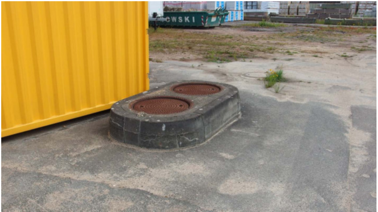
Abb. 11: Blick nach Westen auf die Koaleszenzabscheider (Nr. 19 Ergebnisplan) im Bereich der DK-Eigenverbrauchstankstelle.
